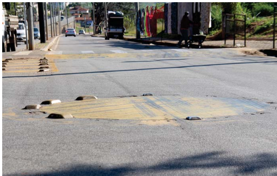
Sinalização precária e parte do redutor de velocidade arrancada.
