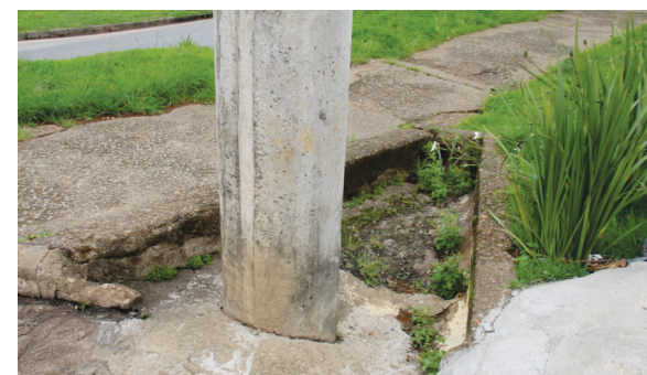
Idosa pisa em falso na vala e ainda se encontra em recuperação pelo acidente
