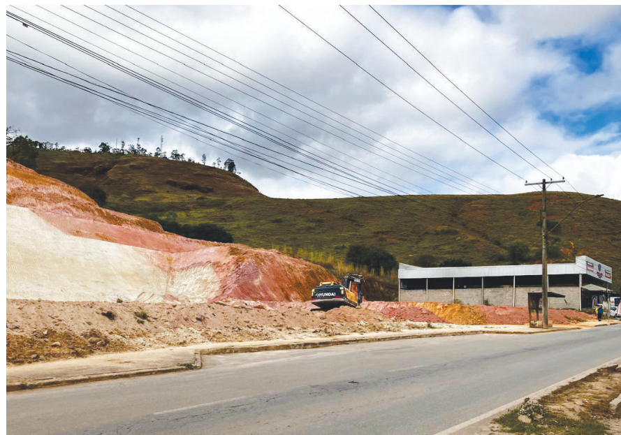
Moradores reclamam da grande quantidade de poeira no Bairro Loanda. Além disso, o excesso de terra está acumulado sobre o passeio de pedestres.
